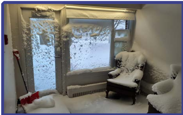
Photos du CMR de Kingston Fenêtres brisées dans le bâtiment des tailleurs
